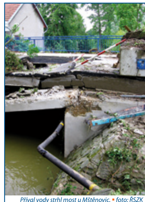
Příval vody strhl most u Mštěnovic. ■ foto: ŘSZK
