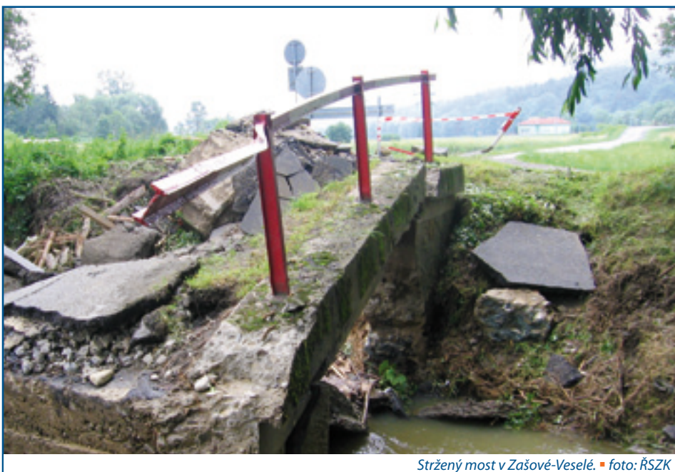
Stržený most v Zašové-Veselé. ■ foto: ŘSZK
